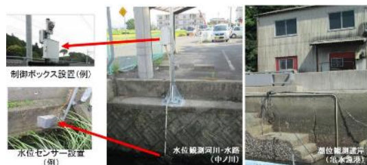
制御ボックス・水位センサー
