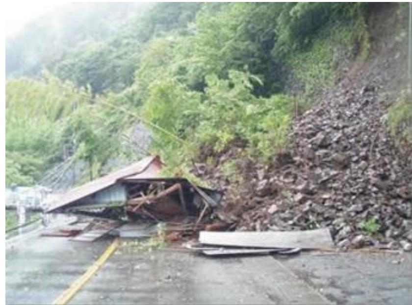
がけ崩れの事例（奥多摩町）
